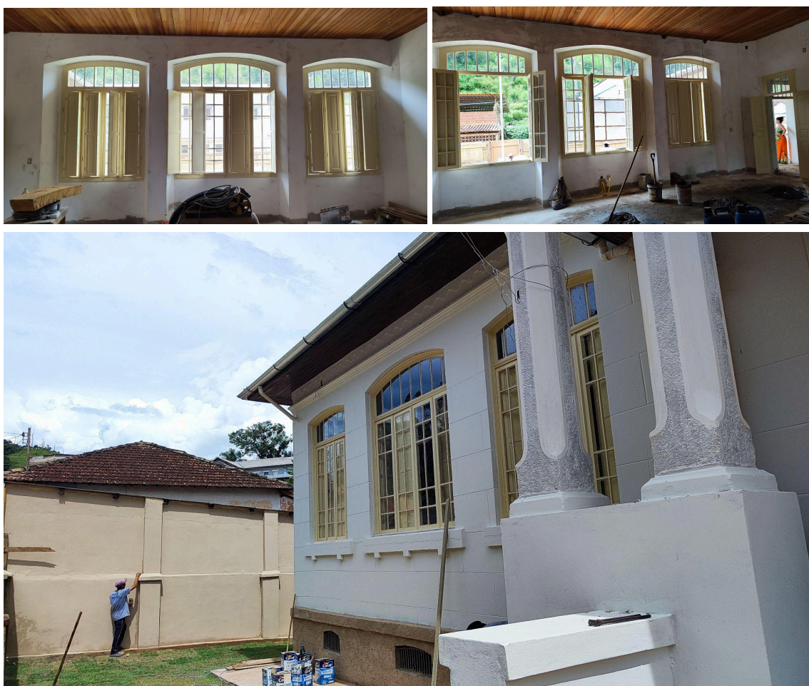
Andamento dos serviços executados nas esquadrias da edificação Autoria: Francielle Ferreira Data: 27/01/2025
